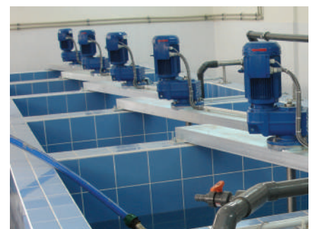
Бассейн, насосная станция и миксеры для перемешивания грязи
